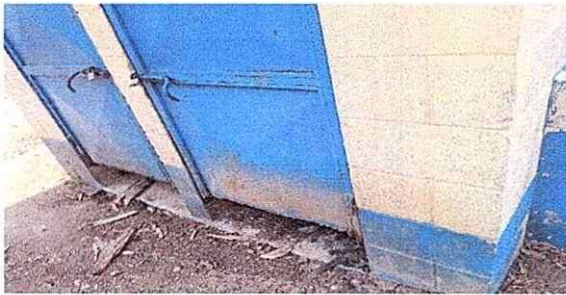
Foto 3: Se observa las puertas de baño a sustituir
